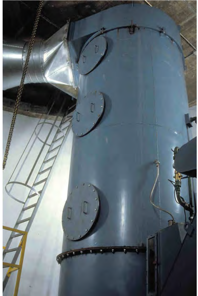
Filtro de vía húmeda
