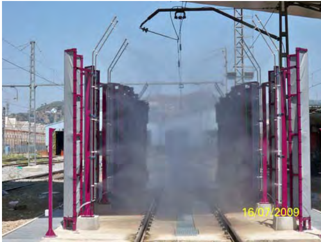
Vista general de la instalación de lavado al paso
