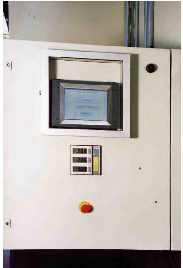
Cuadro eléctrico de control
