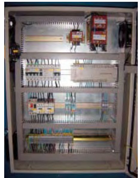
Interior del armario de control
