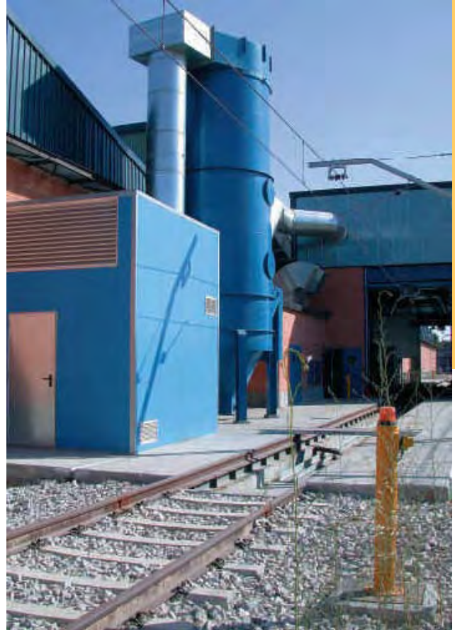
Exterior de la nave con el filtro de vía húmeda
