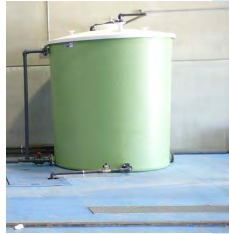
Depósito de agua reciclada
