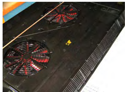
Equipo de aire acondicionado después del proceso de lavado
