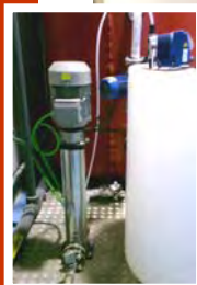
Detalle de bomba vertical y dosificación de detergente
