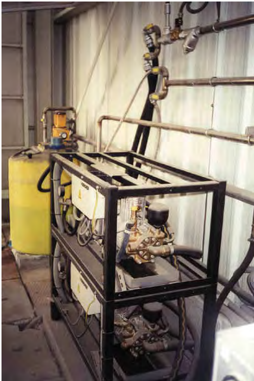
Grupo de bombas de alta presión
