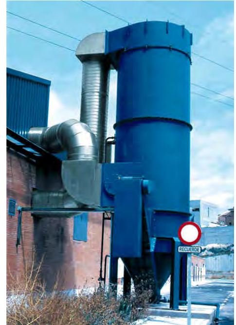
Filtro de vía húmeda
