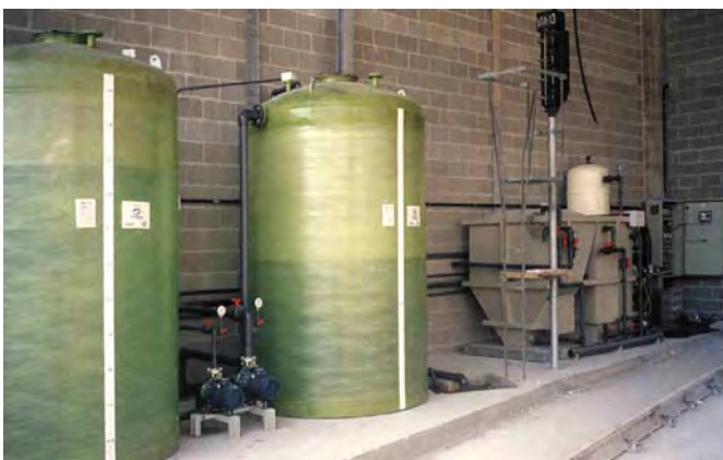
Recicladora y depósitos de agua reciclada y agua de red
