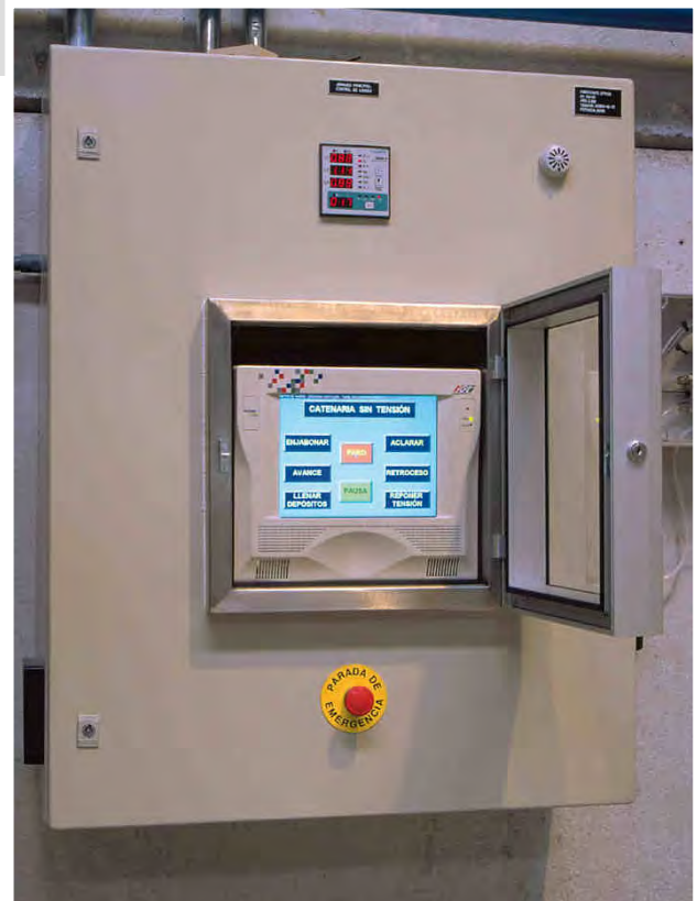
Armario general de potencia y control
