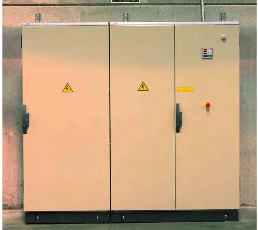
Armario de potencia
