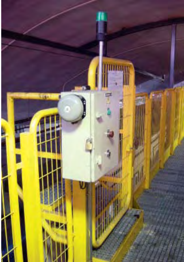
Posición de armario en pasarela
