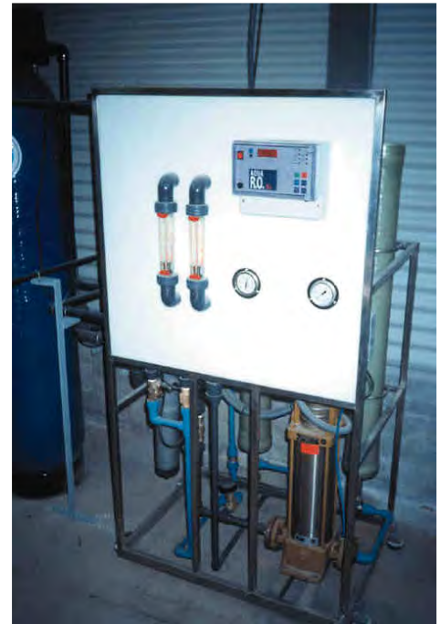
Equipo generador de agua osmotizada
