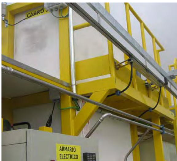
Sistema de alimentación eléctrica a los carros de lavado
