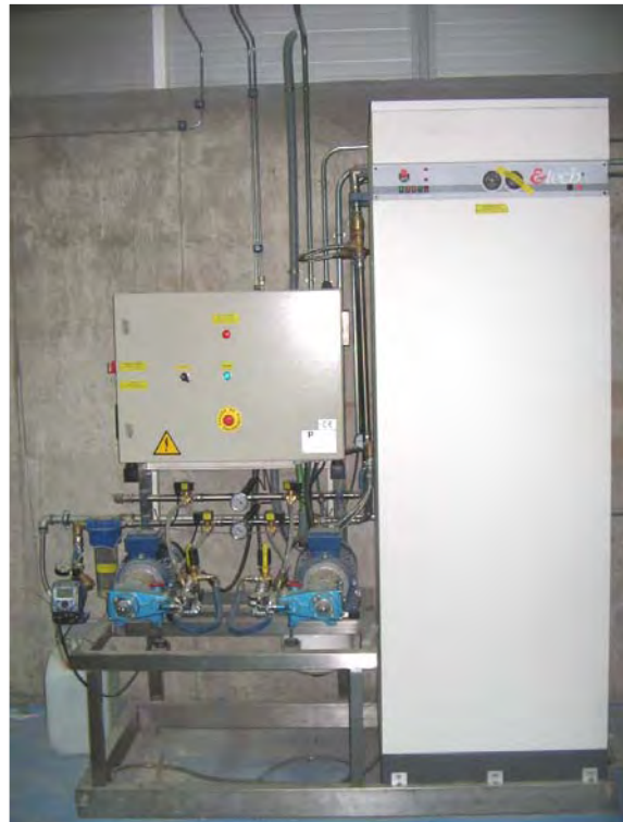
Equipo compacto de producción de agua caliente, con sistema de acumulación
