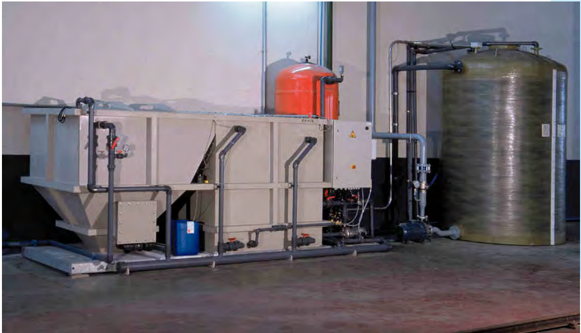
Recicladora y depósito de agua reciclada
