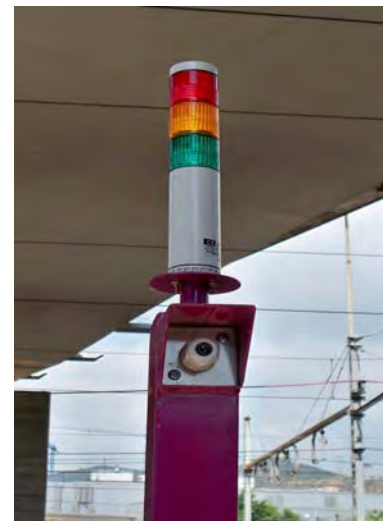
Detalle de Fotocélula de detección Y señalización luminosa.
