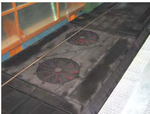
Equipo de aire acondicionado antes del proceso de lavado
