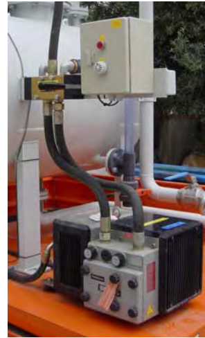
Detalle de compresor, válvula y cuadro eléctrico
