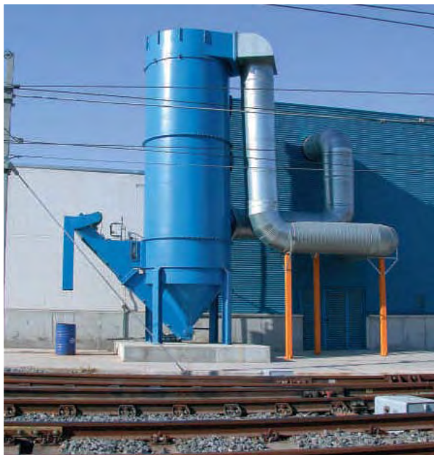
Filtro de vía húmeda
