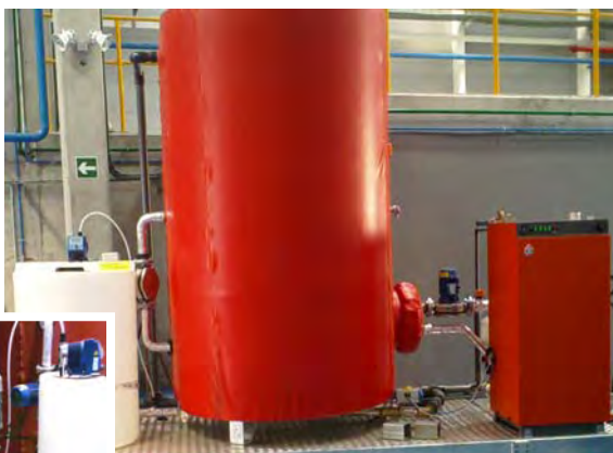
Sistema de producción de agua caliente
