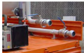
Detalle de conexiones de aspiración y vaciado
