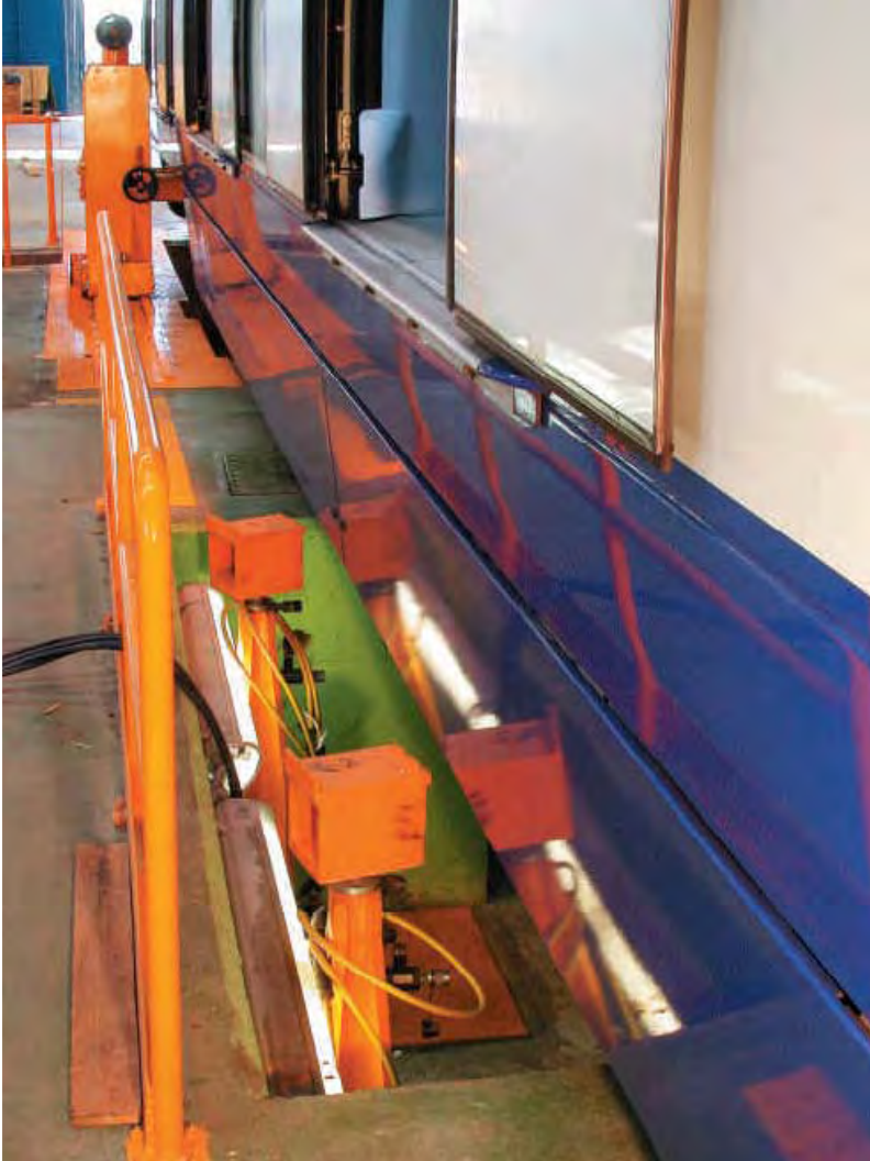
Foso para equipos de elevación
