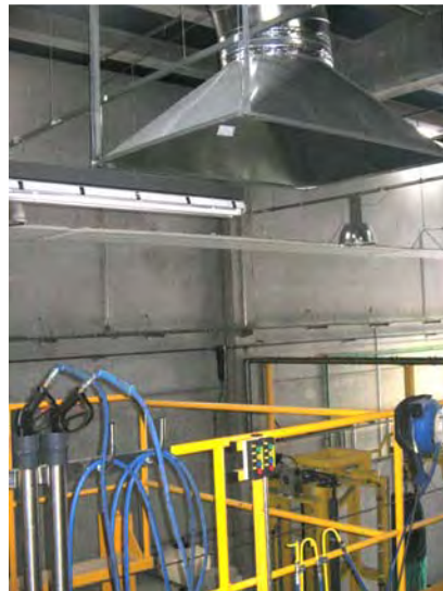
Sistema de aspiración de vapores
