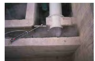
Sistema automático de canalización de agua
