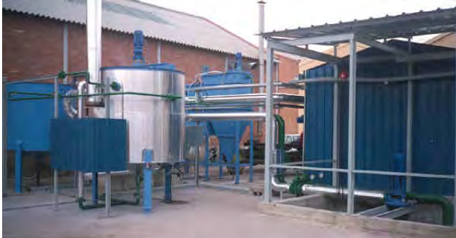
Vista general de la instalación automática de lavado de bogies
