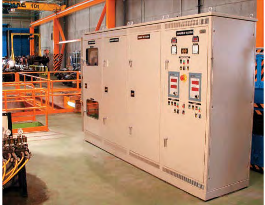
Cuadro eléctrico de potencia y control del equipo predictivo
