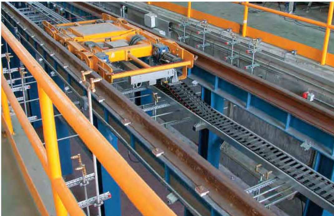
Lavado automático de bogies con carro de arrastre
