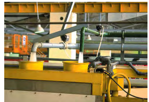
Llenado de depósitos de agua de red y agua reciclada
