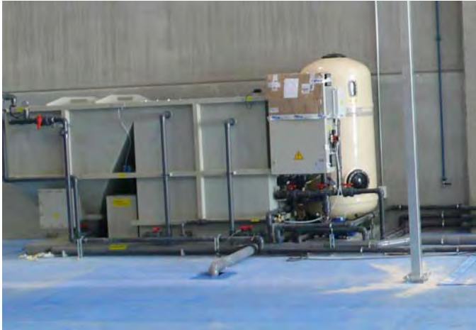
Recicladora de agua procedente del lavado
