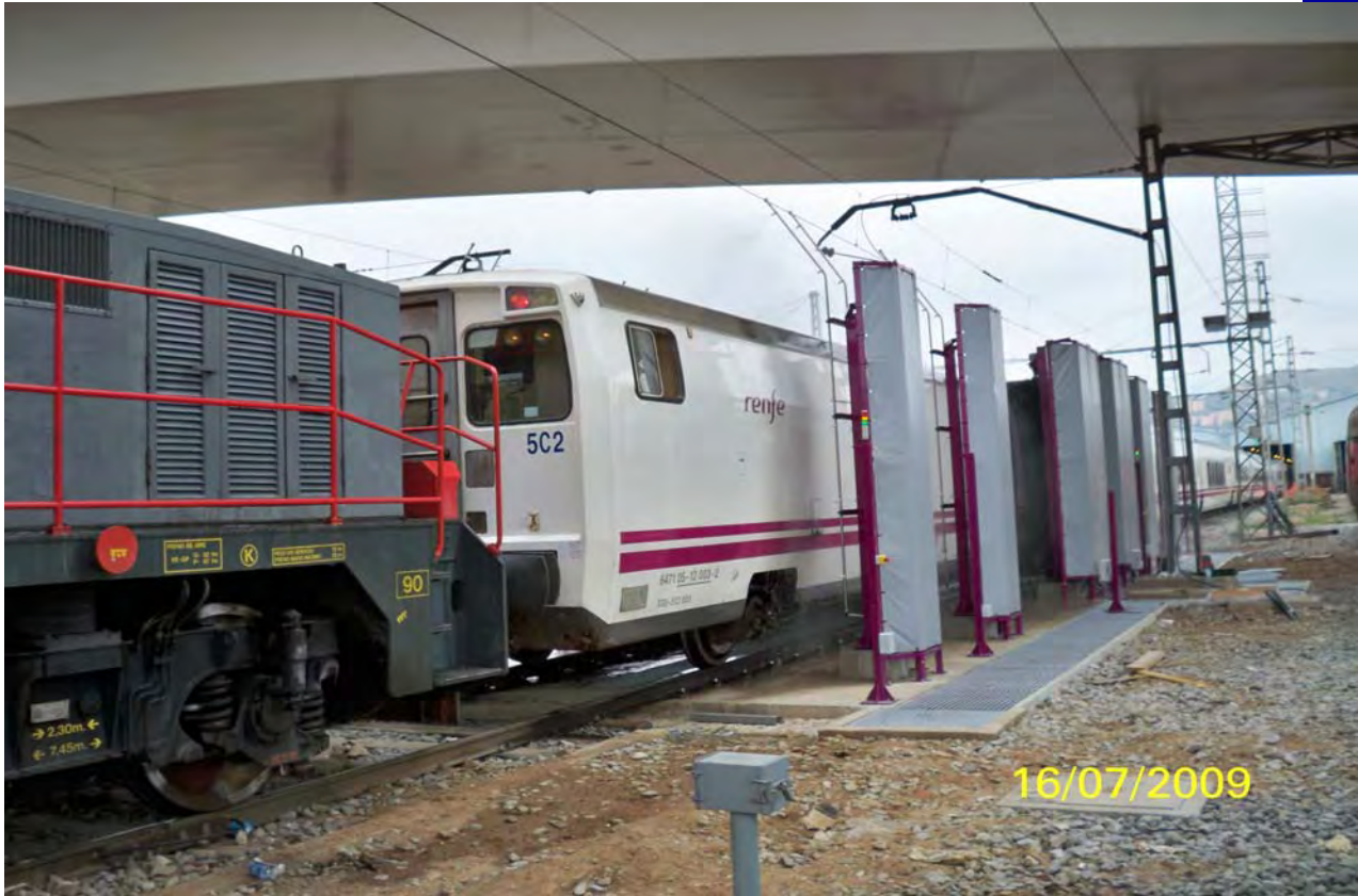
Túnel de lavado al paso de Trenes TALGO
