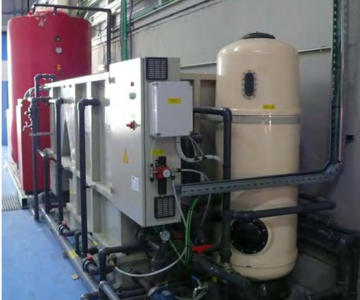
Recicladora de agua procedente del lavado
