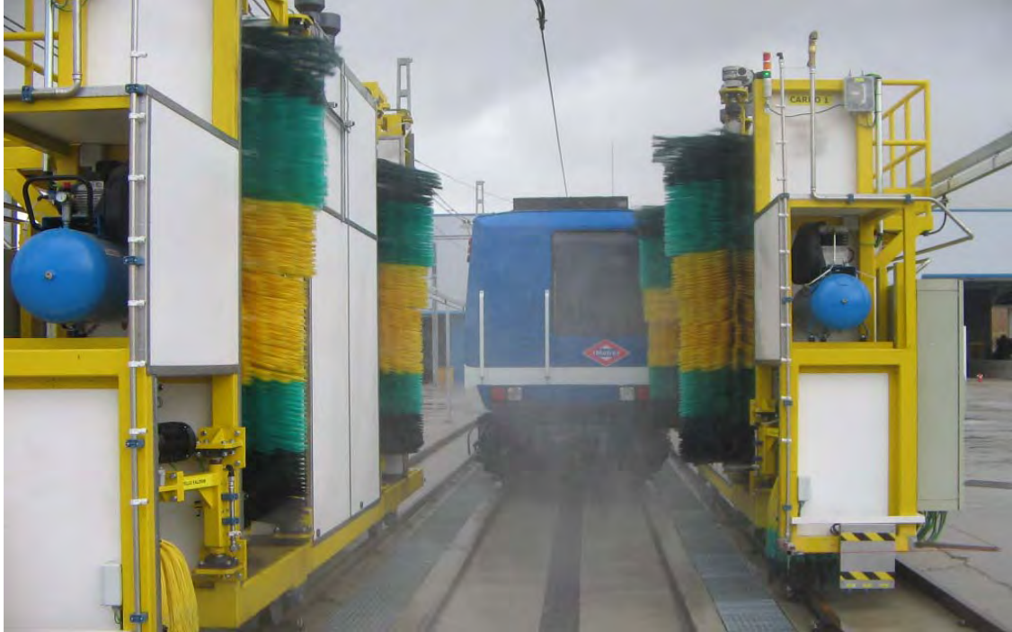
Vista general de túnel de lavado
