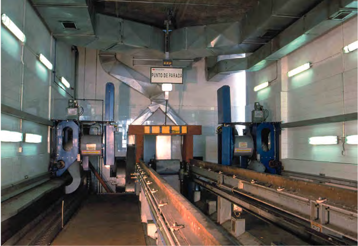
Vista general de la nave de soplado de Laguna
