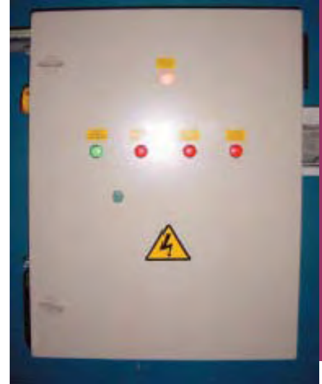
Armario de control
