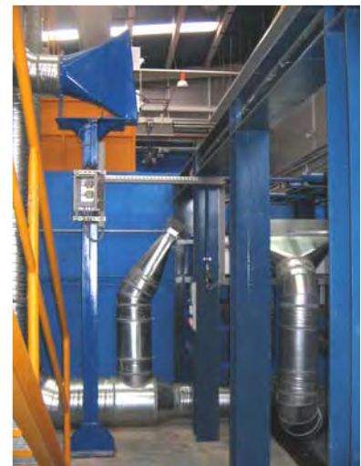
Bocas de aspiración de laterales y fondos
