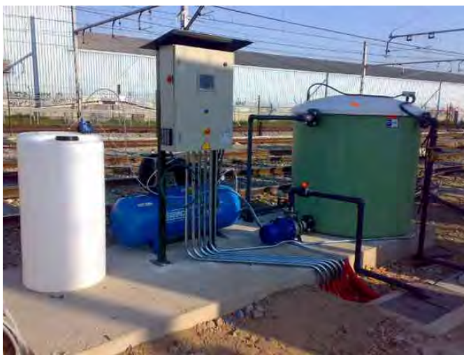
Sistema de Control
