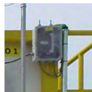
Comunicación vía Wi-Fi
