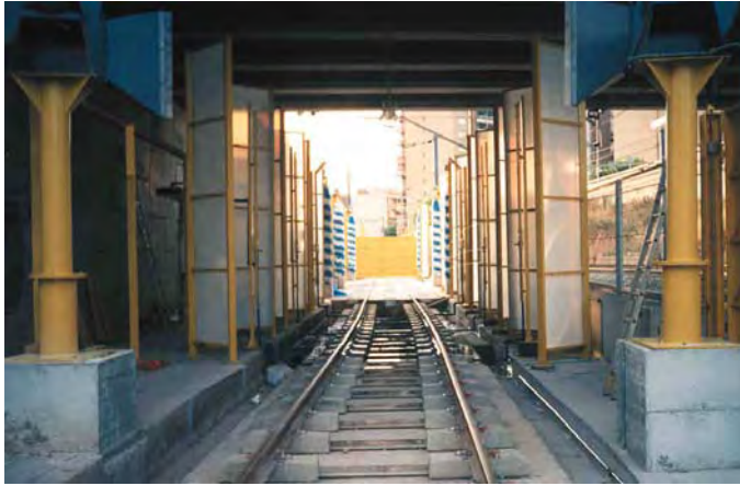
Vista general de la instalación de lavado al paso
