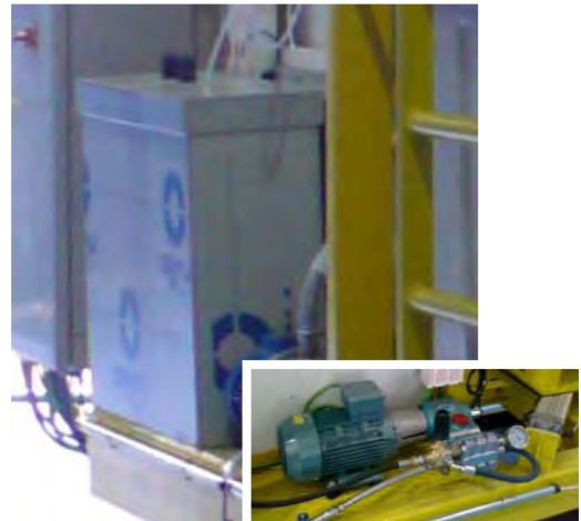
Detalle de depósito de detergente y bomba de alta presión
