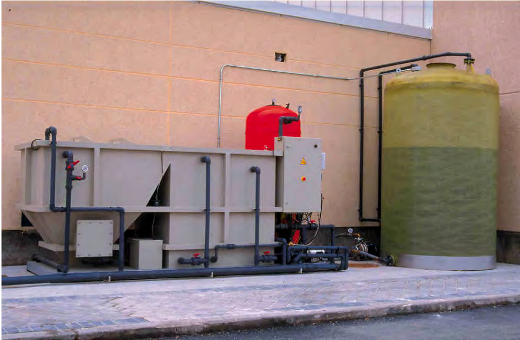
Recicladora y depósito de agua reciclada
