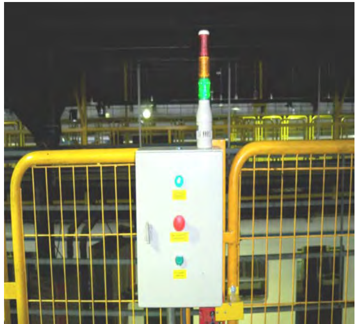
Armario secundario de control y baliza luminosa/sonora
