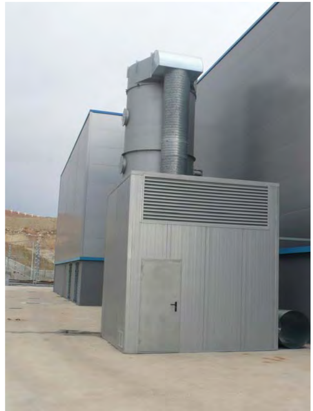
Exterior de la nave con el filtro de vía húmeda
