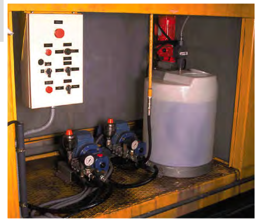
Depósito de detergentes y bombas de alta presión
