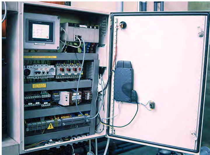
Detalle de cuadro eléctrico de recicladora con módem GSM para telemantenimiento
