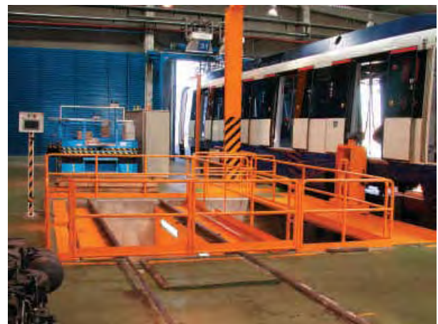
Vista general de la mesa bajabogies
