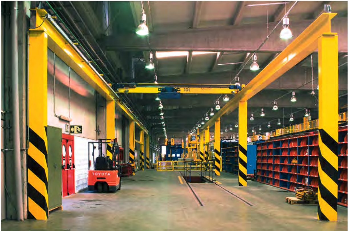
Vista general del puente grúa de Hortaleza
