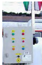
Cuadro eléctrico y luces de comunicación
