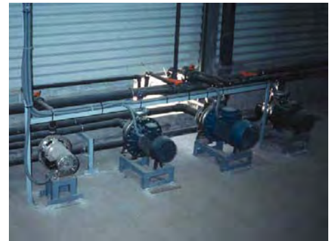
Equipo de bombeo
