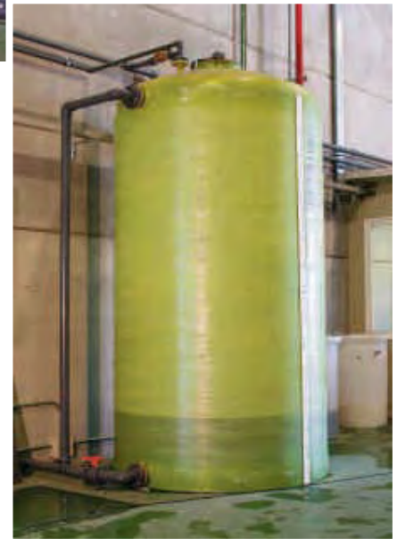
Depósito de agua reciclada
