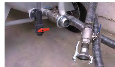
Detalle de conexiones de aspiración y vaciado
