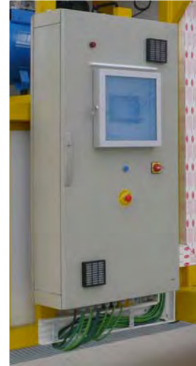
Armario de potencia y control de carro de lavado
