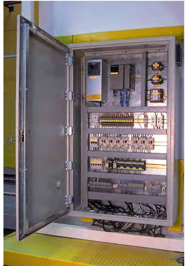
Armario de potencia y control de carro de lavado
