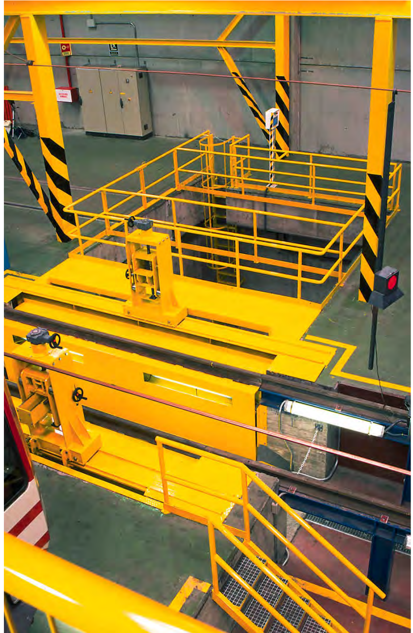
Vista general de la mesa bajabogies
