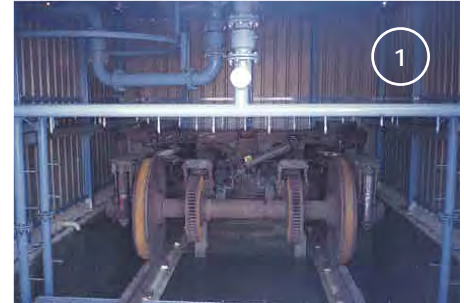
Entrada del bogie sucio
